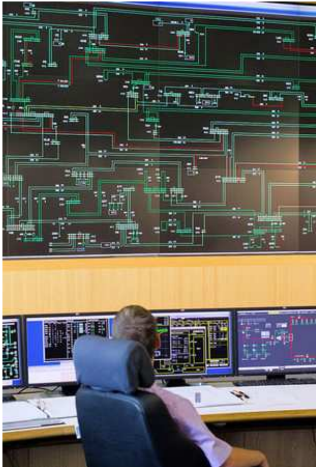
Die Netzwächter: Schaltzentrale eines Stromnetzbetreibers in Brandenburg Foto: dpa
